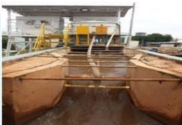
Figura 13: Captação de água bruta Fonte: A autora
