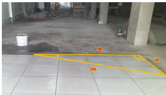
Figura 9 - O uso do esquadro no assentamento de cerâmica em piso Fonte: Autoria própria
